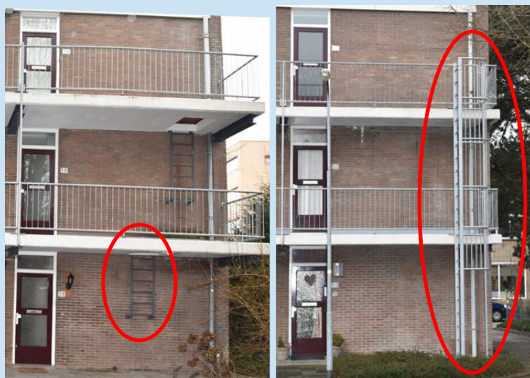
Figuur 2.2 Links een voorbeeld van een vluchtluik, rechts een vluchtladder. Bron: Brandweer Gelderland-Midden
