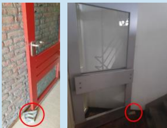
Figuur 2.9 Voorbeelden van openstaande deuren die zijn vastgezet
