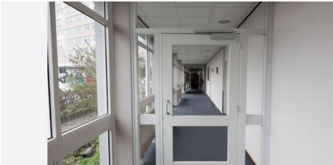
Figuur 2.6 Situatie die voldoet aan het Bbl: er staan geen spullen in de gang.
