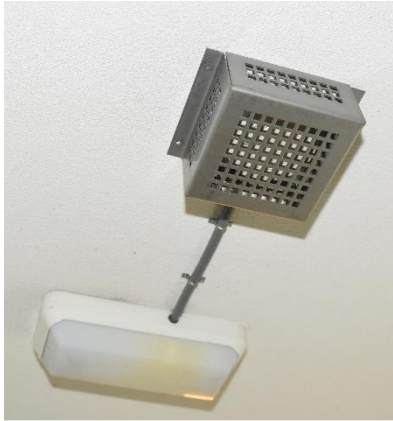
Figuur 2.7 Afgeschermd rookmelder in een trappenhuis (Bron: Brandweer Gelderland-Midden)
